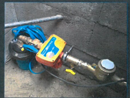
Aknában elhelyezett kút, szakszerű zárással, szivattyú vezérlővel és vízmennyiség mérővel
